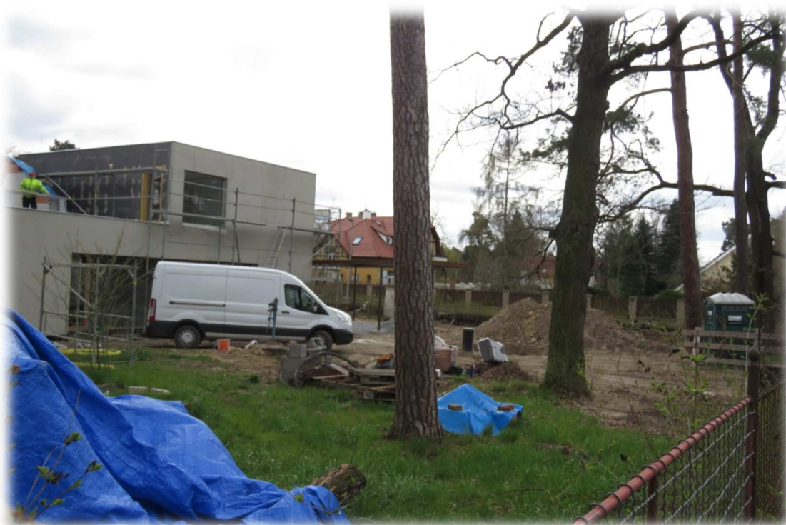
Obrázek 53: Poškození dřevin stavbou začínají již nadostatečným vymáháním zákonných opatření ochrany dřevin na staveništi. nepřípustné skladování materiálu v korunovém průmětu, pojezdy kořenového systému, pořanění na pni i náběhů, výkopové práce, kontaminace a zhutnění vedou k závažným škodám na majetku investora a k úhynu stromů chráněných zákonem ve veřejném zájmu.
