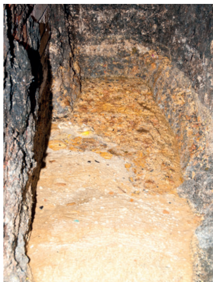
Znečištěná kanalizace v pražském podzemí.
