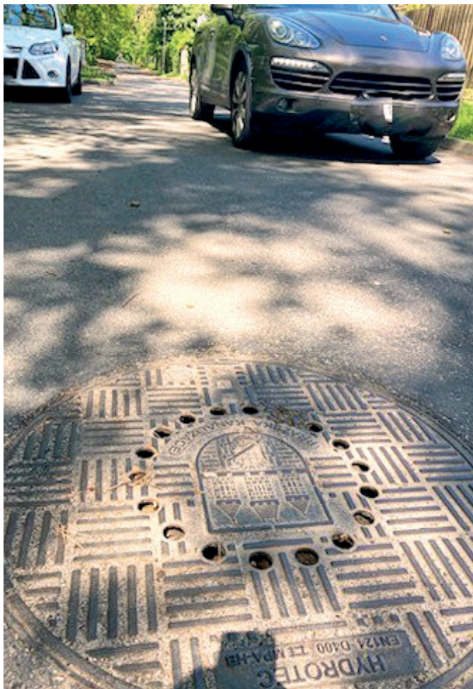
Zápach z kanalizace trápí v Klánovicích především v létě.
