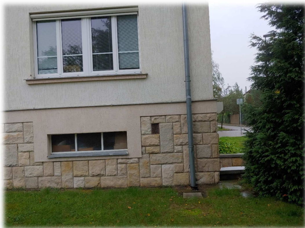
Obrázek 1: Dešťový svod na budově úřadu MČ Praha – Klánovice
