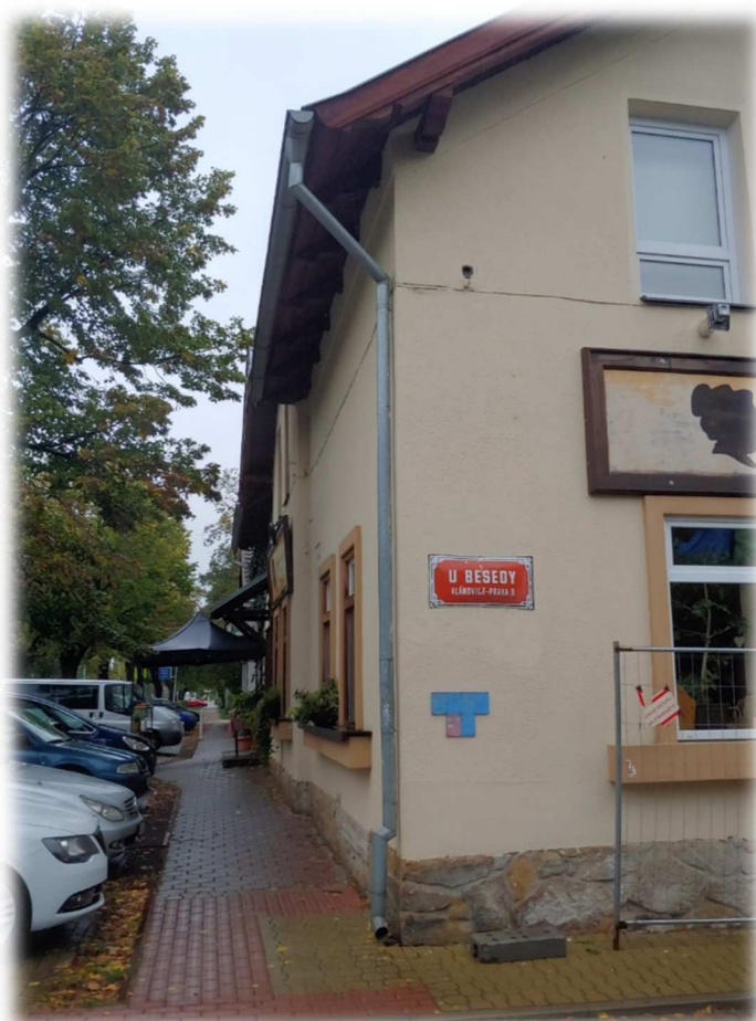
Obrázek 21: Dešťový svod na budově Nová Beseda v ulici Slavětínská
