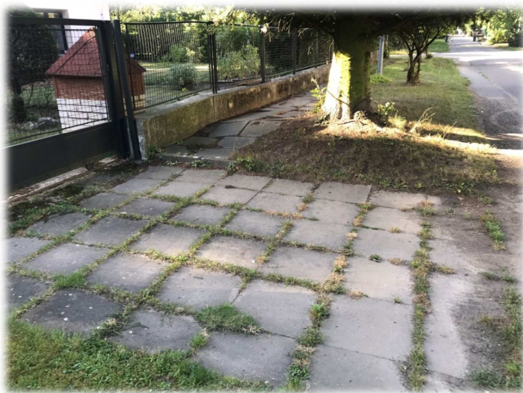
Obrázek 49: Chodník poškozený kořeny v ulici Voňkova
