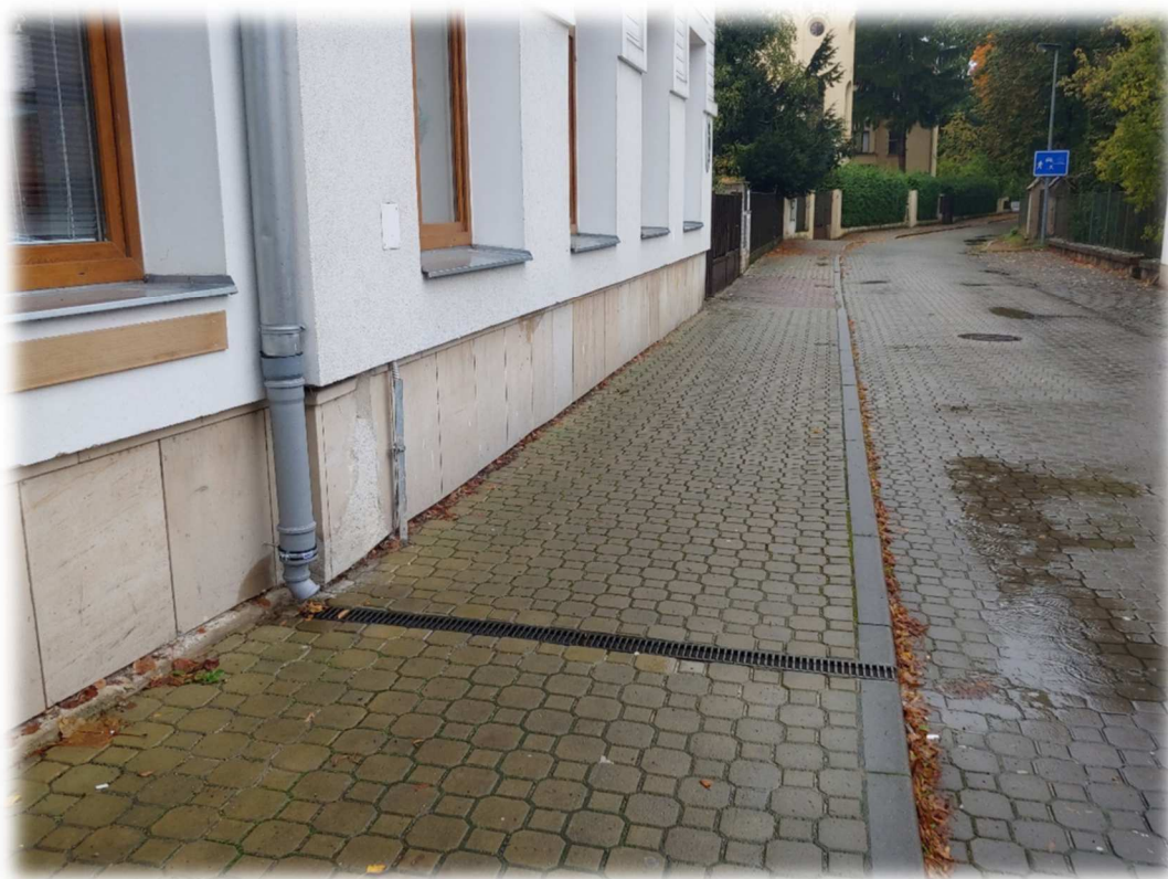
Obrázek 9: Dešťový svod ZŠ Masarykova směrem do ulice Smržovská (Smržovská 1)
