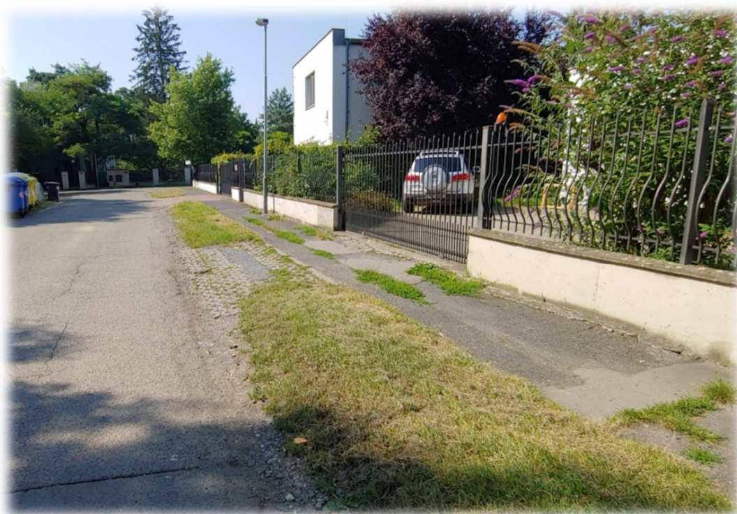
Obrázek 53: Chodník ve špatném stavu ul. V Koutku
